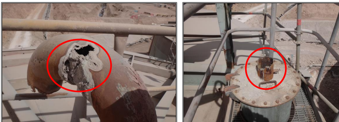
Figura N° 8: Corrosión en venteo y boquilla TK-3
