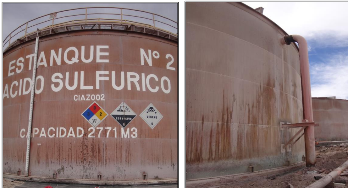
Figura N° 5: Vista general TK-2
