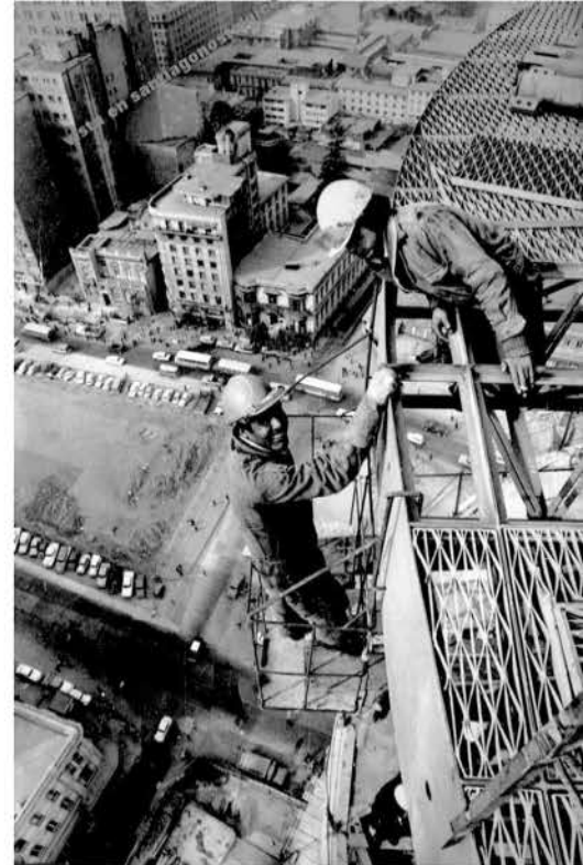
Parrillas de piso Acustermic en Torre Entel año 1970
